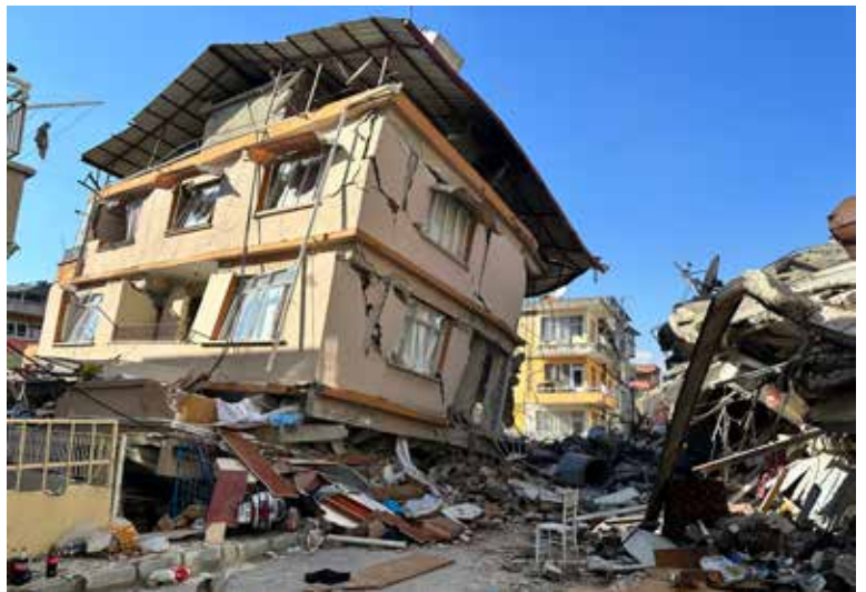
Instabiele en ingestorte gebouwen. De onderste woonlagen zijn bijna allemaal ingestort.
